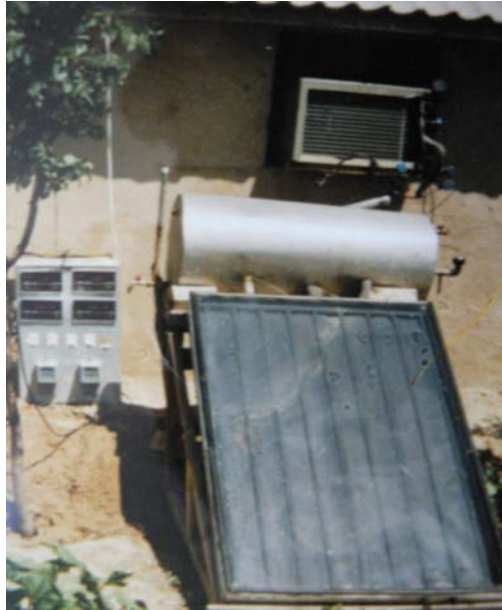
Şekil 1.b. Çift fazlı güneş enerjisi kaynaklı ısı pompası sistemi deney tesisatının fotoğrafı (kollektör eğim açısı 45°)
